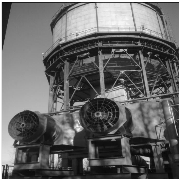
Рис. 1. Вторая очередь системы осушки сжатого воздуха С-ОСВ на ОАО «МЗ «Электросталь»
